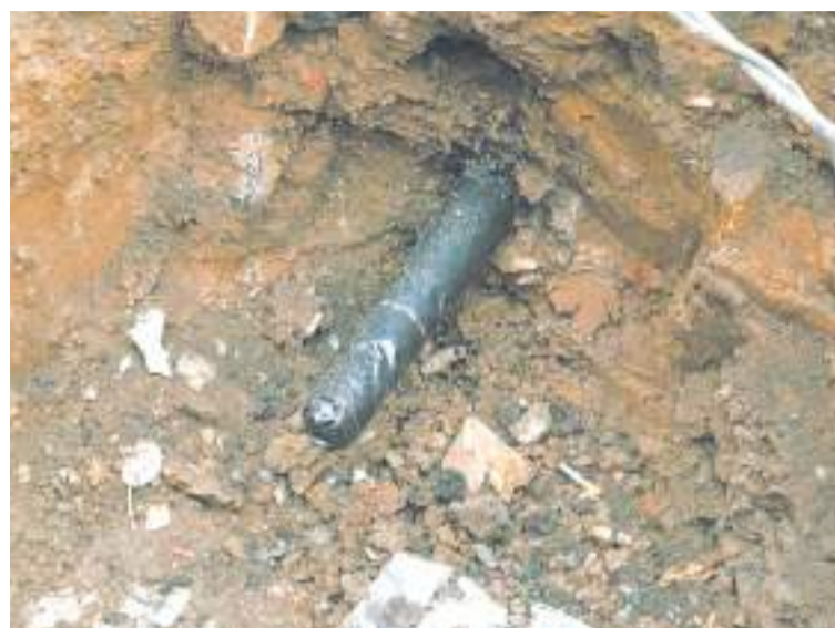
Та самая газовая труба, которая нуждается в восстановлении
